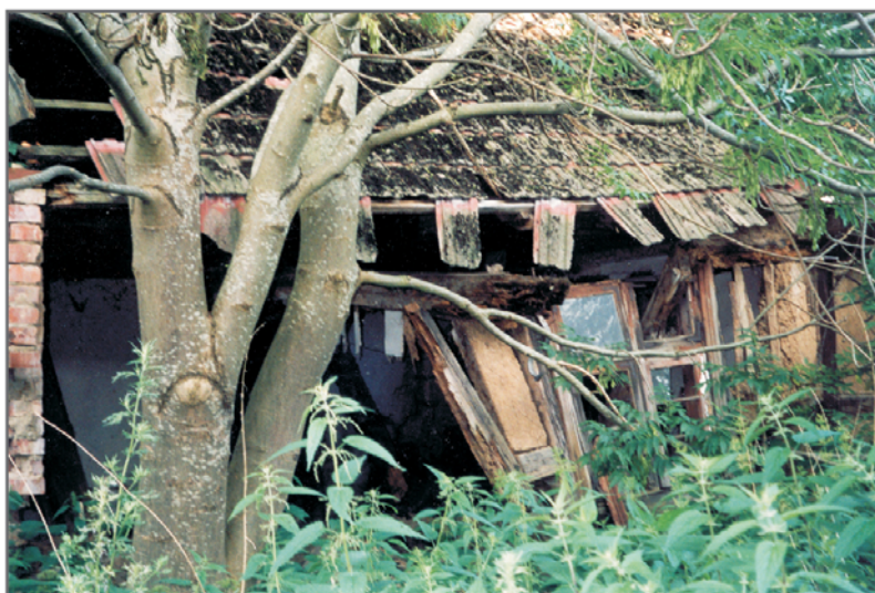
B. Staniewice - ruina budynku mieszkalnego o konstrukcji ryglowej
